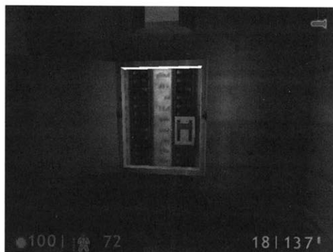
Der Sicherungskasten für die Stromversorgung dieses Abschnitts
